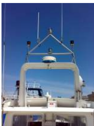
Antenas y batería de reserva
