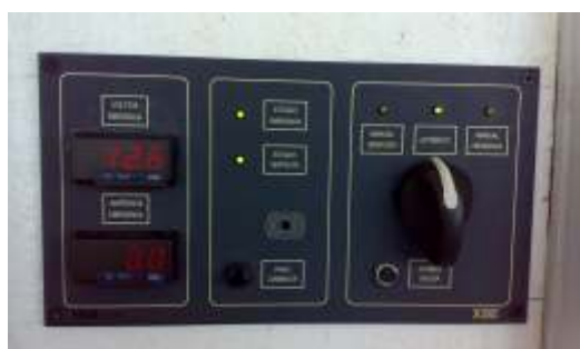
Cuadro de conmutación de batería de reserva
